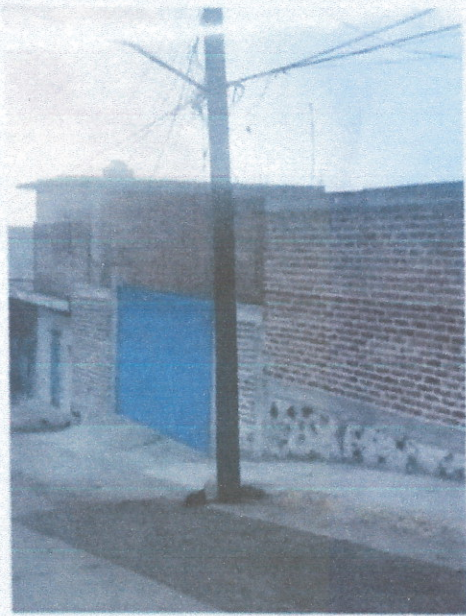
Poste a remplazar
